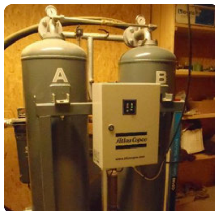
Assécheur d'air pour compresseur air comprimé - Photo : FCBA
